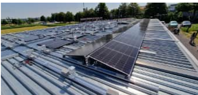
Bild: Photovoltaik-Anlage auf der Interims-Kita im Gebiet Schelmenwiesen
